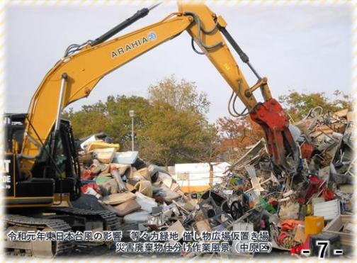
令和元年東日本台風の影響 等々力緑地 催し物広場仮置き場 災害廃棄物保管状況 (中原区)
